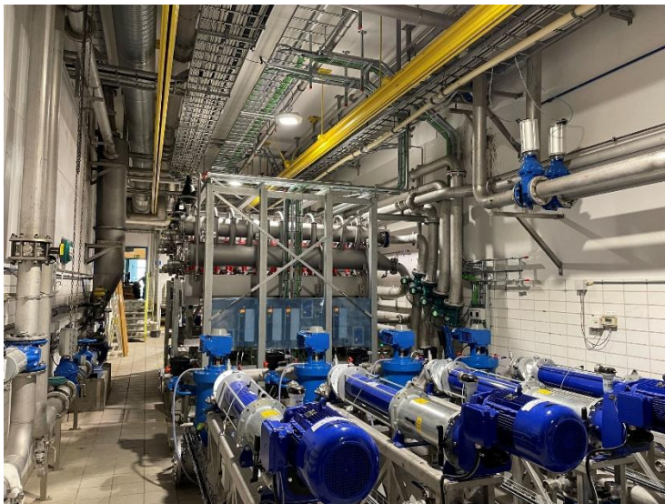
S::Select®-Anlage KA Damhusaen (350.000 EW), installiert in einer Maschinenhalle
