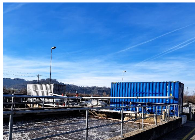
S::Select®-Anlage KA Oberes Wiggertal (62.000 EW), fertig installiert in zwei Containern, erst eine Straße, nach erfolgreichem Test -> Vollausbau mit 2. Container
