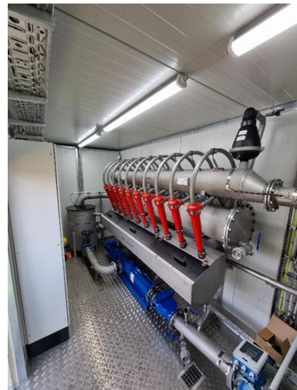
S::Select®-Anlage KA Borken (130.000 EW), fertig installiert im Container
