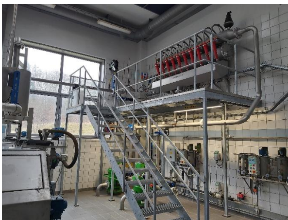
S::Select®-Anlage KA Viby (120.000 EW), installiert im vorhandenen Gebäude
