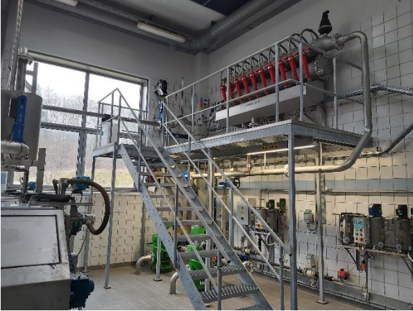
S::Select®-Anlage KA Viby (120.000 EW), installiert im vorhandenen Gebäude
