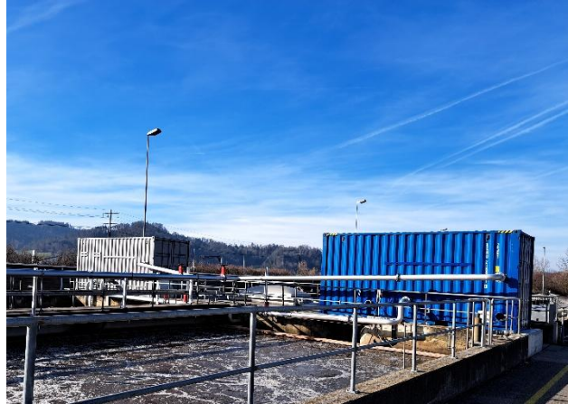
S::Select®-Anlage KA Oberes Wiggertal (62.000 EW), fertig installiert in zwei Containern, erst eine Straße, nach erfolgreichen Test -> Vollausbau mit 2. Container
